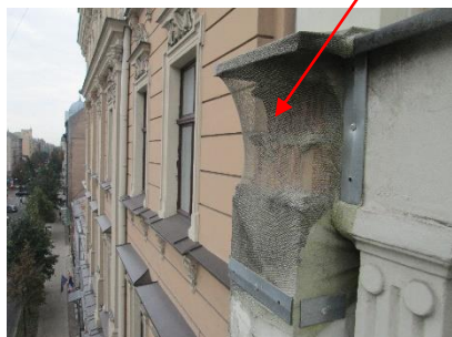
83.att. Balkona margu bojājumi.
